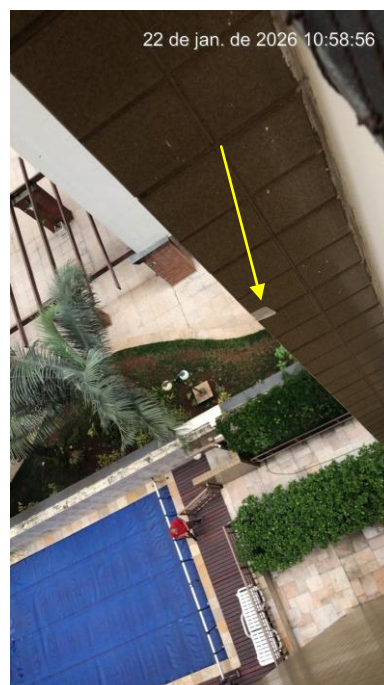
Figura 51 – Fita com a marcação exata da fissura no revestimento externo
