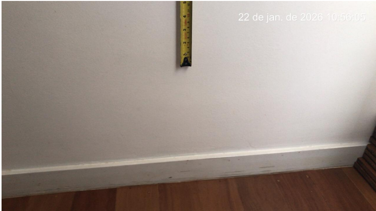
Figura 48- Verificação exata da altura onde ocorre fissura no revestimento (azulejo) externo
