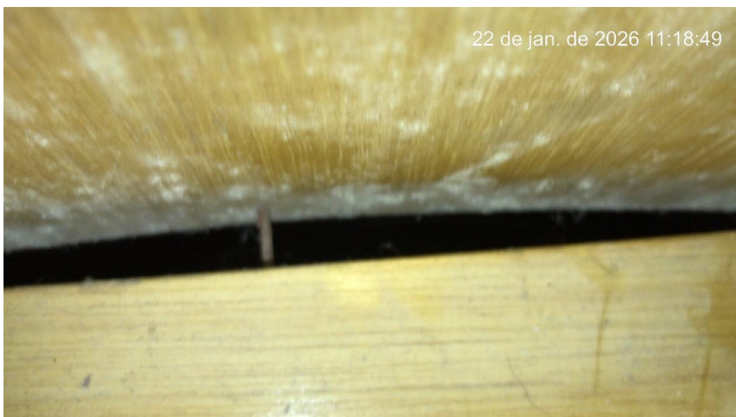
Figura 61 - Presença de bolor (seca e antiga)
