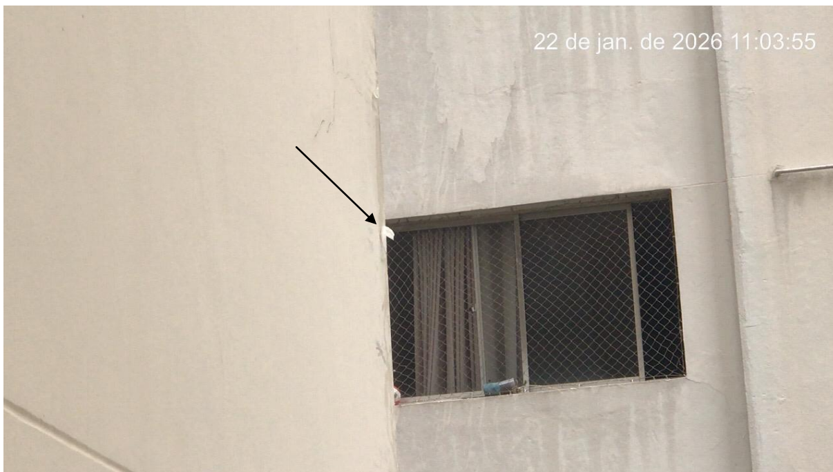
Figura 54 - Fita com a marcação exata da fissura no revestimento externo
