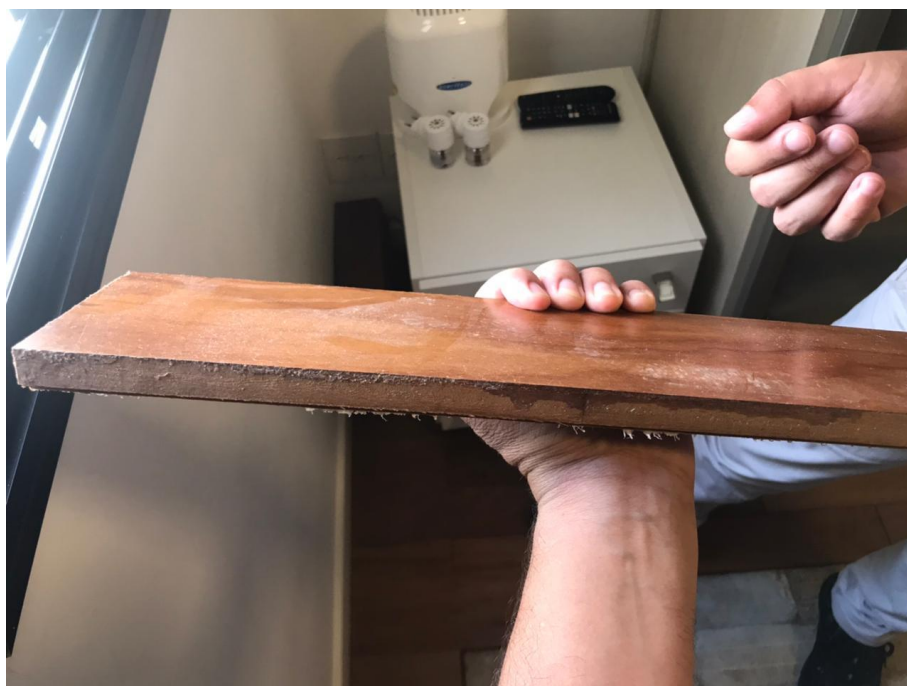
Figura 40 - Piso de madeira tipo taco com peças soltas após ocorrência de chuva intensa
