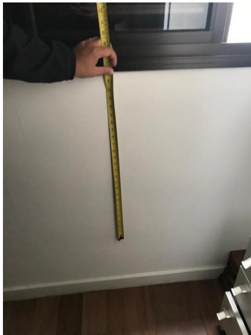
Figura 46-Verificação exata da altura onde ocorre fissura no revestimento (azulejo) externo
