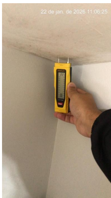
Figura 55 Aferição de umidade realizada com medidor de umidade Stanley STHT 77030
