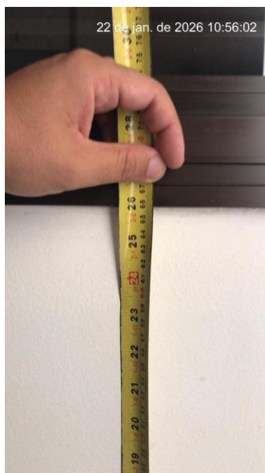
Figura 47- Verificação exata da altura onde ocorre fissura no revestimento (azulejo) externo
